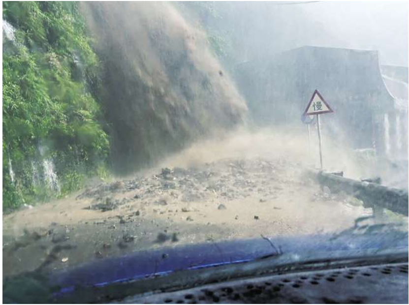
▲ 南投縣仁愛鄉本月 4 日雨勢不斷，鄉內多處道路出現泥流，道路邊坡沖下泥水彷彿瀑布。(民眾提供)
