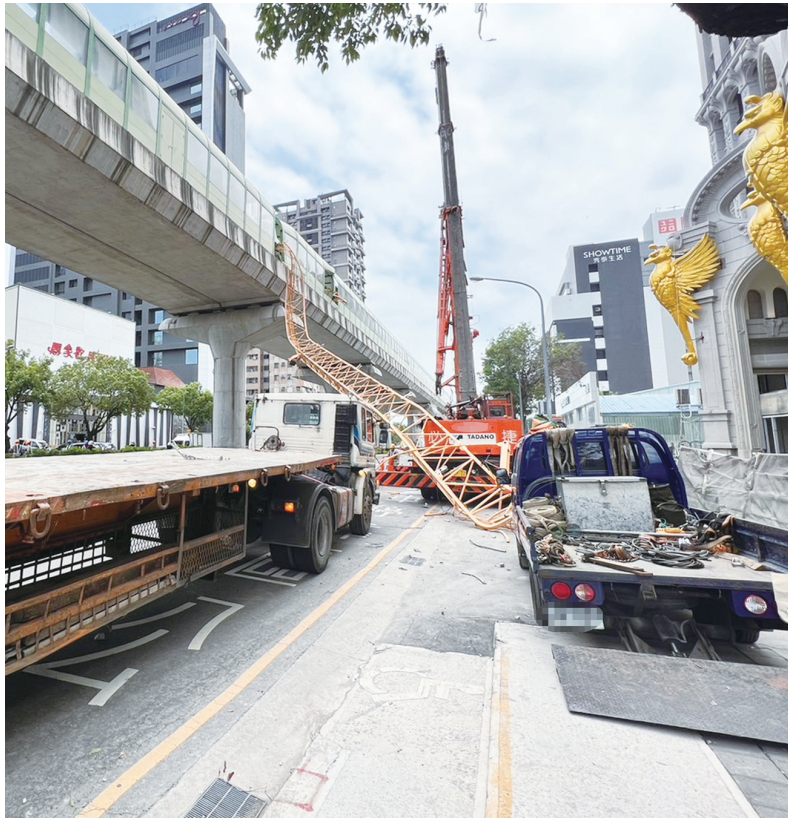
▲ 台中市南屯區文心南五路與文心路口一處建案，10 日中午發生吊車吊臂倒塌意外，剛好壓到一旁台中捷運綠線豐樂公園站的列車，致使搭乘捷運的台中逢甲大學法律系助理教授身亡。
