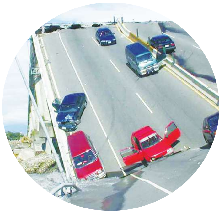
▲ 2000年8月27日下午兩點30分左右，高屏大橋橋墩斷裂，橋面長達100公尺下陷，16輛車墜落，22名乘客輕重傷。(網路截圖)
