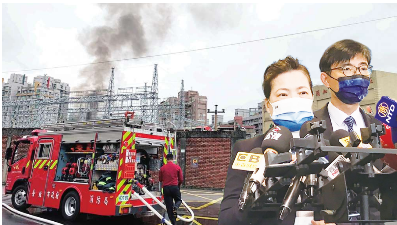
▲ 王美花表示，起火、濃煙與匯流排跳脫，導致 12 日的事件。圖為萬隆一次變電所冒出黑煙，警消獲報到場馳援。(中央社)
