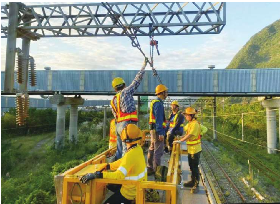
▲台鐵近幾年發生多次老舊電車線斷落，造成嚴重誤點。台鐵19日發布新聞稿表示，上千公里的電車線更新，預計年底前全部完成。
