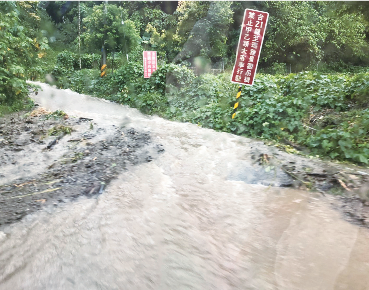
▼高雄山區15日晚間至16日清晨豪雨不斷，造成災情。圖為那瑪夏區通往瑪雅段那次關溪的產業道路受損。（photo by 高雄市那瑪夏區公所）
