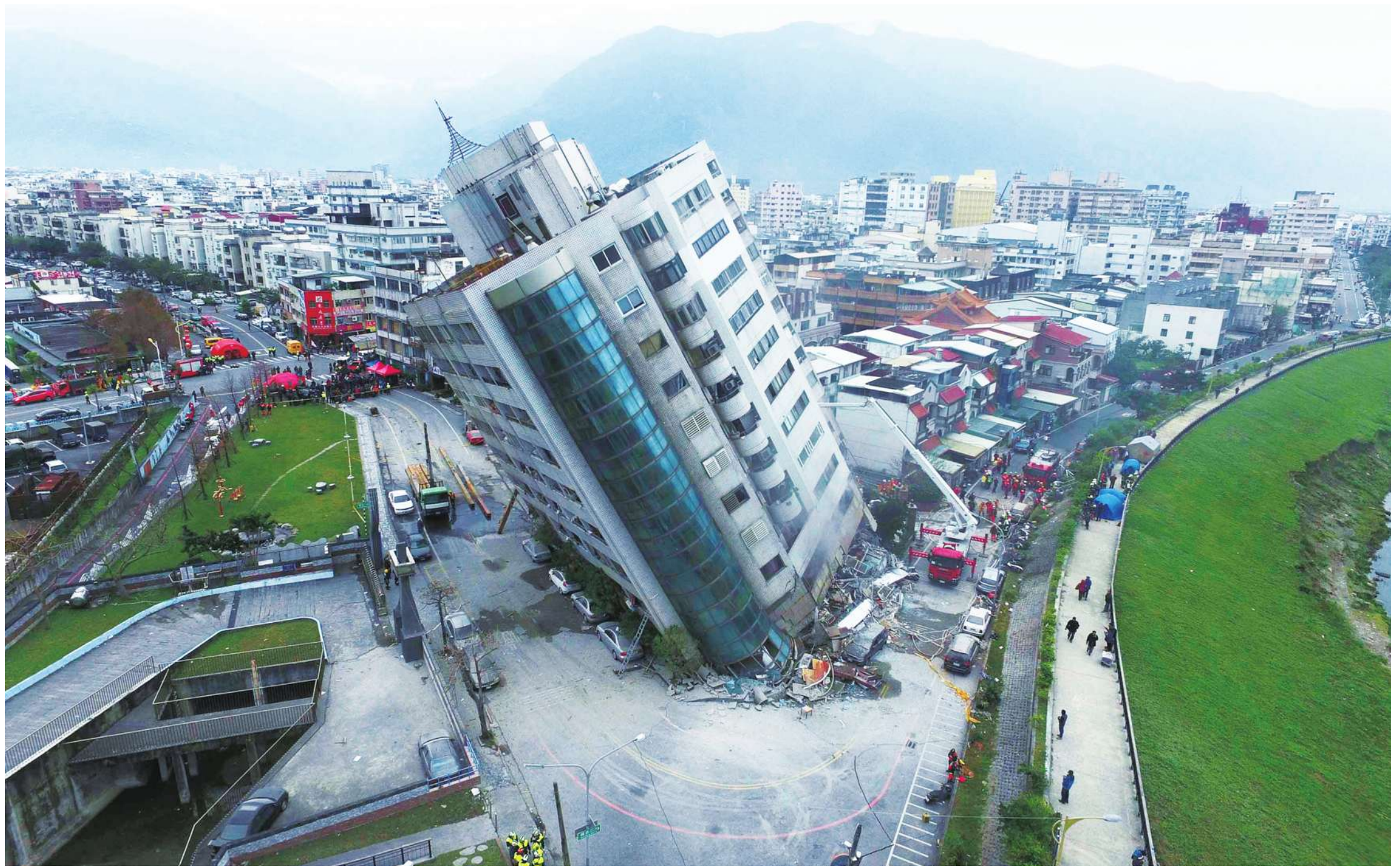
▲ 0206 花蓮發生芮氏規模 6.0 強震，造成雲門翠堤大樓嚴重傾斜。（中央社）
