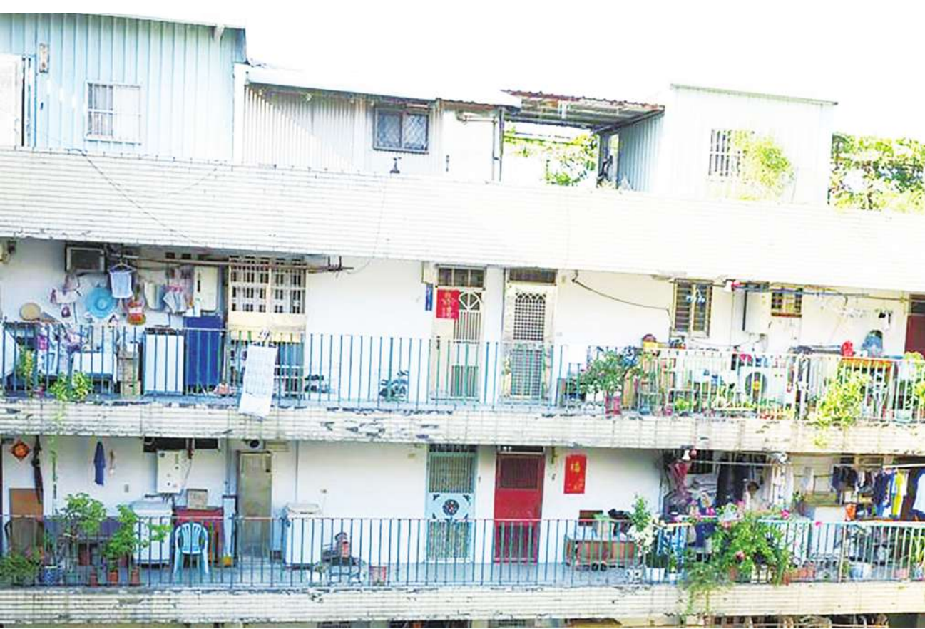
▲ 房子結構一定要穩固，也要針對抗震能力不好的房屋做補強動作，才不會使居民的生命受到危害。（中央社）
