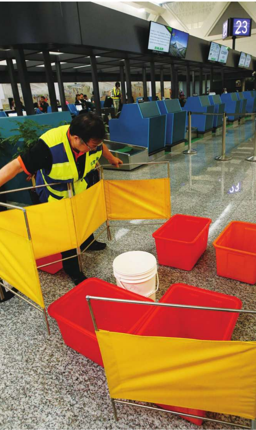
▲ 卡努帶來的豪大雨雖沒造成人命傷亡，卻對設施造成不少傷害。圖為桃園國際機場 13 日緊急搶修天花板漏水情形。(中央社)
